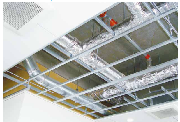
校内にある実物の教材(天井裏の給排水設備)
